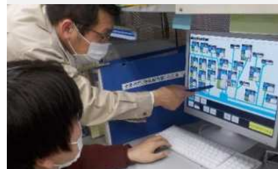
水門監視操作システム操作
