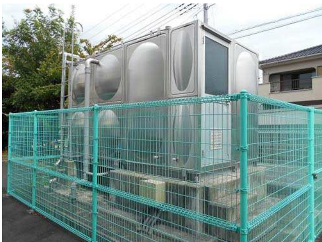
⑮防火水槽
