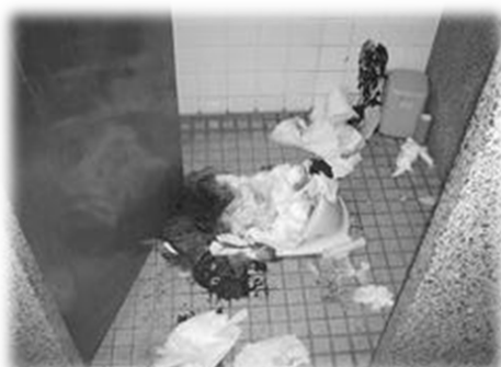
断水により汚れたトイレ
