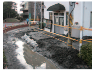
▲ 地盤沈下により傾いた交番
