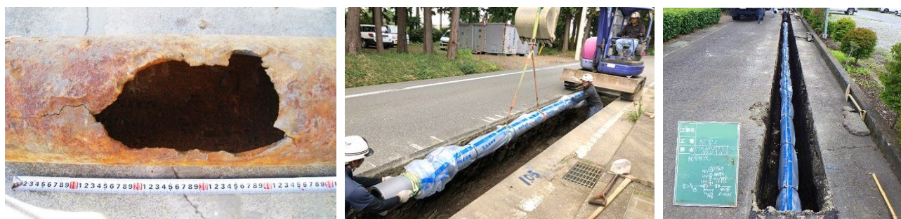
図4-4 老朽化した水道管 と 布設替工事の様子
