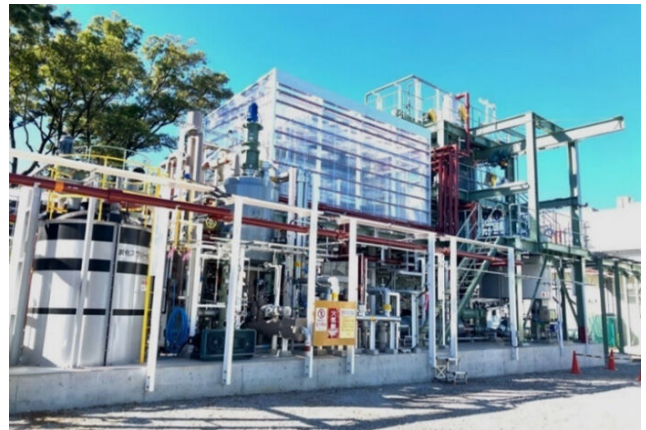
図 西部浄化センター水熱炭化施設
