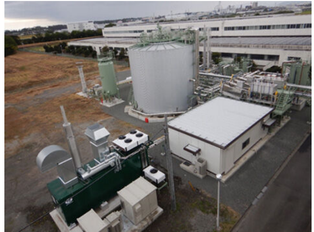
図 東部浄化センターの消化ガス発電施設
