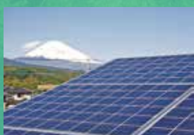
▲裾野市庁舎の太陽光パネル
