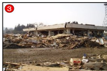
気仙沼国道維持出張所の被災状況
