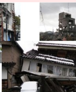
木造建築物の倒壊状況（穴水町）
