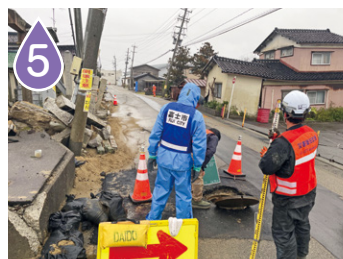
2月18日～21日 かほく市 被害が確認された下水道にて カメラを用いた 2次調査
