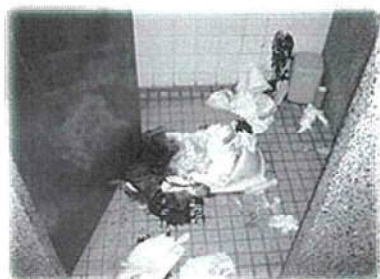
断水により汚れたトイレ
