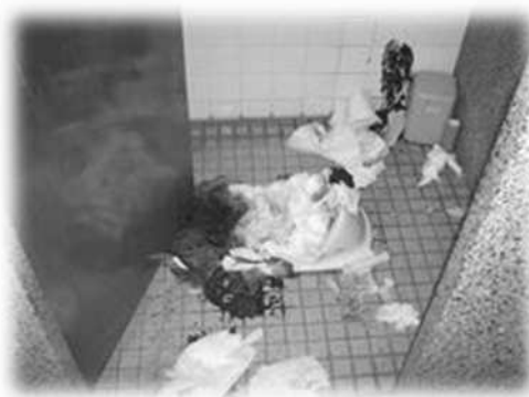
断水により汚れたトイレ
