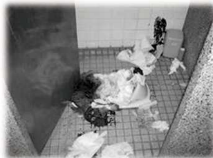
断水により汚れたトイレ
