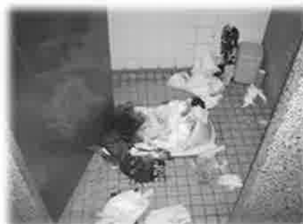
断水により汚れたトイレ
