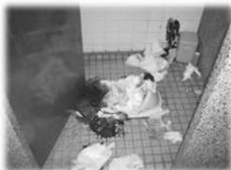
断水により汚れたトイレ
