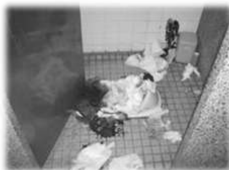
断水により汚れたトイレ
