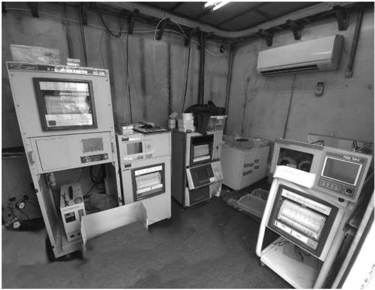
自排局の測定器と記録計（自排宮島）
