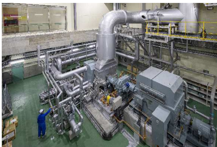
新環境クリーンセンターの蒸気タービン（中央）と発電機（右手前）
