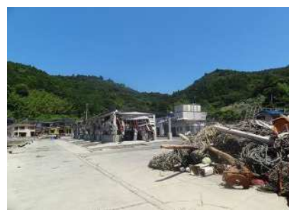
津波により被災した漁港施設
