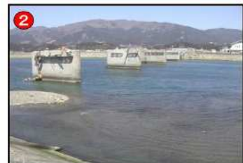
▲岩手県陸前高田市国道45号 気仙大橋上部工の流出
