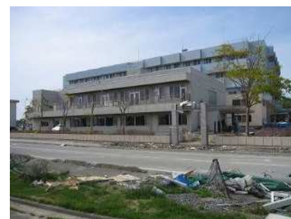
津波により被災した病院施設
