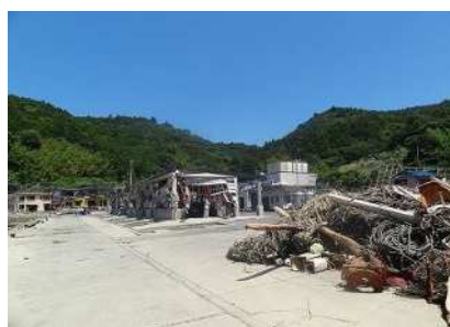
津波により被災した漁港施設
