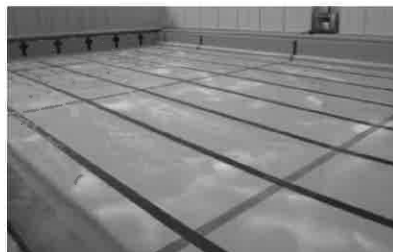
きれいになったプール
