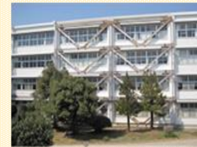
老朽化した校舎
