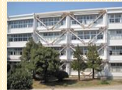
老朽化した校舎
