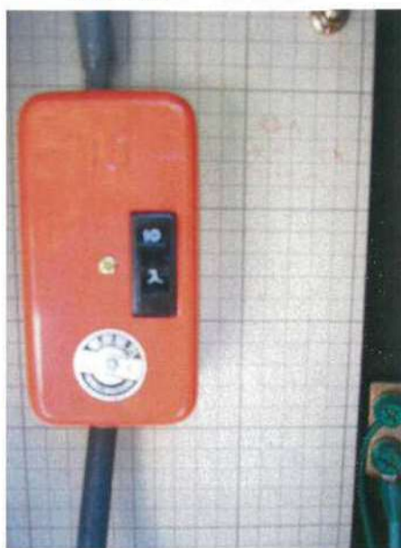
電源の確認6(落雷時)
