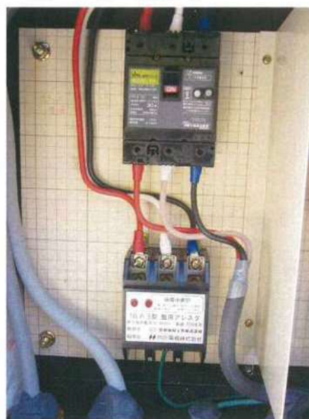
電源の確認7(落雷時)
