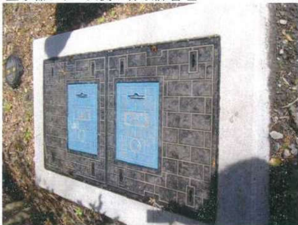
直結ブースターポンプ
