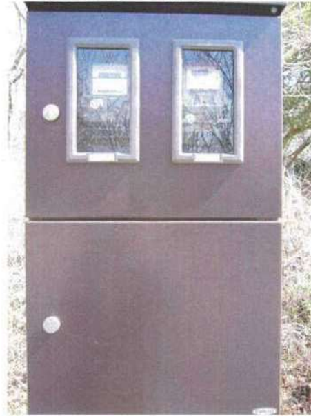
電源の確認4(落雷時)
