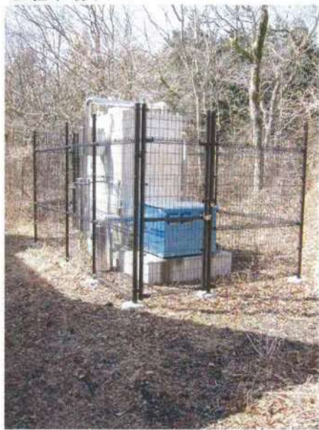
北駐車場ポンプ
