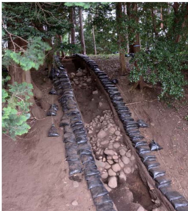
【写真1】 前方部側面の崩落石の状況
