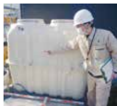
▲合併処理浄化槽
