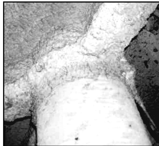
吹付けアスベスト
