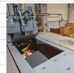
可燃ごみ破砕機で細かくする
