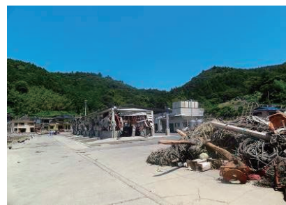
津波により被災した漁港施設
