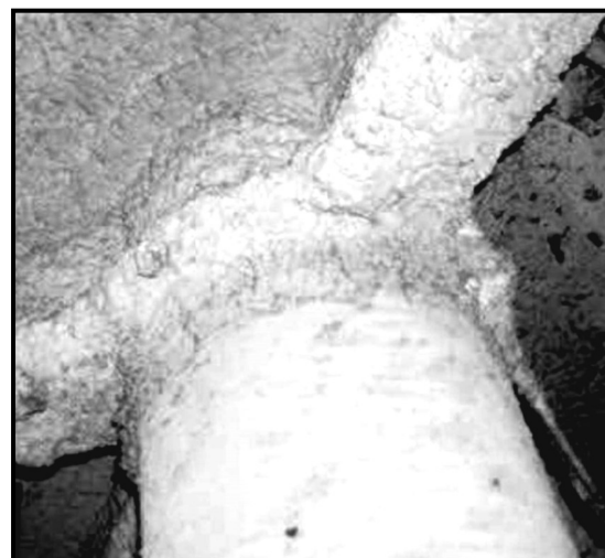
吹付けアスベスト
