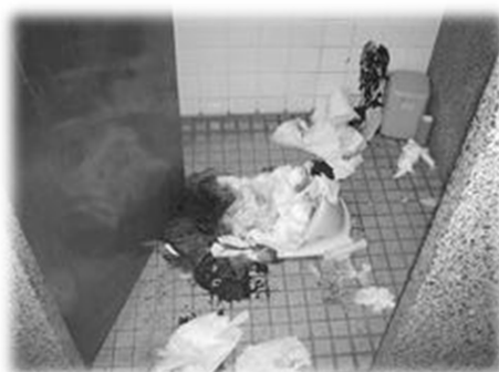
断水により汚れたトイレ
