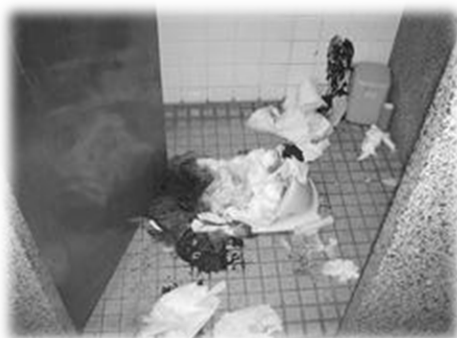
断水により汚れたトイレ
