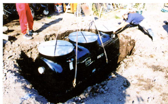
合併浄化槽の設置を推進します。
