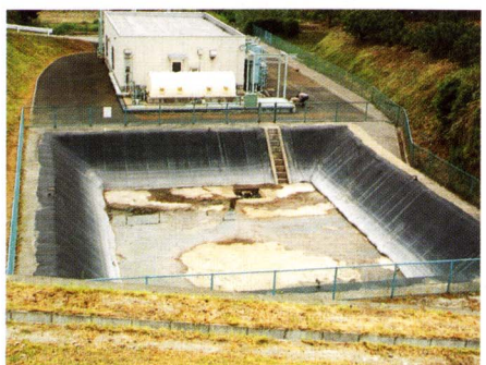
浸出水処理施設
