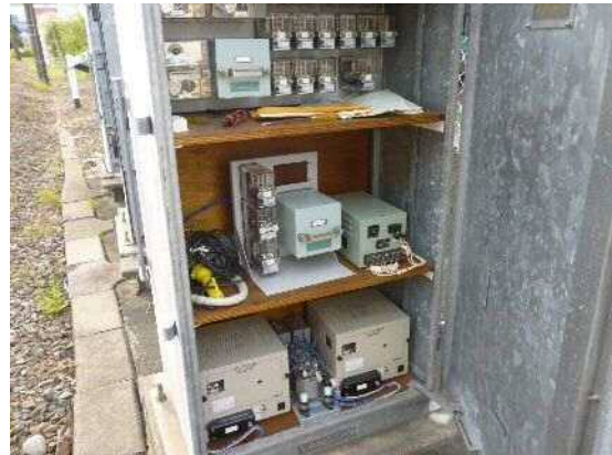
～踏切制御装置～
